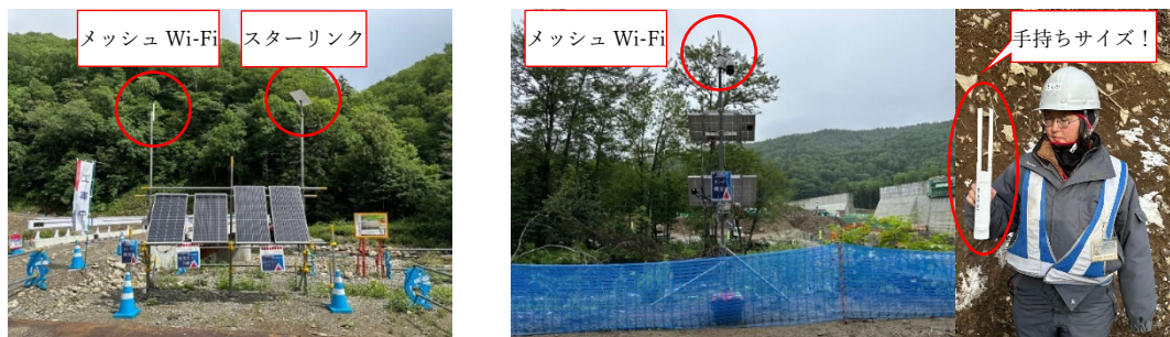
写真-1 スターリンク、メッシュ Wi-Fi 設置状況
