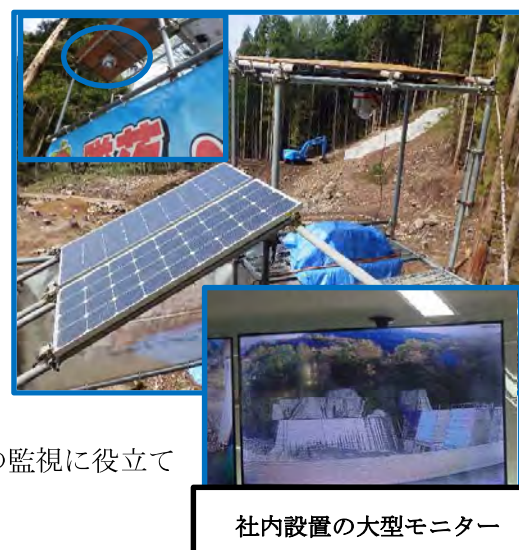
【写真-7 Web カメラ設置状況】
