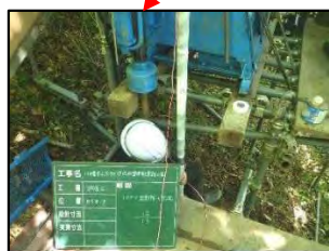
写真-10 パイプ歪計・水位計
