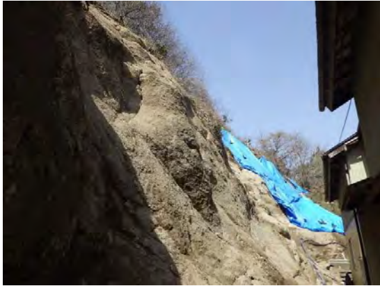
写真-2 崩落斜面現況1
