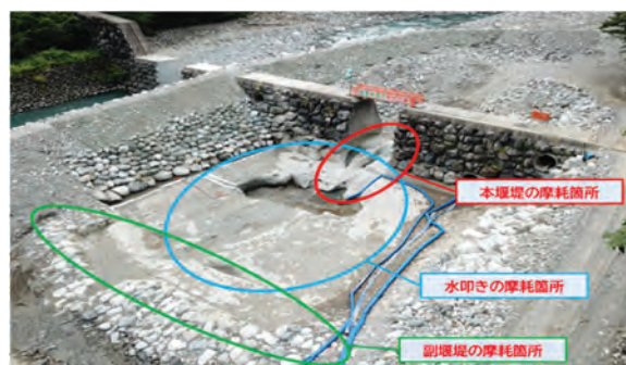
写真-6 積土砂の除去後（摩耗状況の確認）
