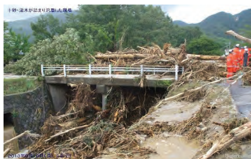
写真 1 台風 18 号による被害 ※1
