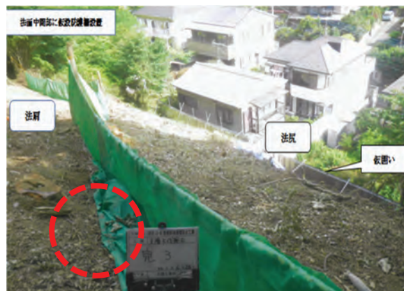
【法肩方向からの落下物】
