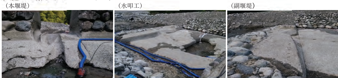
写真-8 各構造物の摩耗状況 (黒薙川第4号砂防堰堤)
