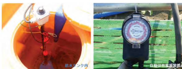
写真-14 自動散水使用機器
