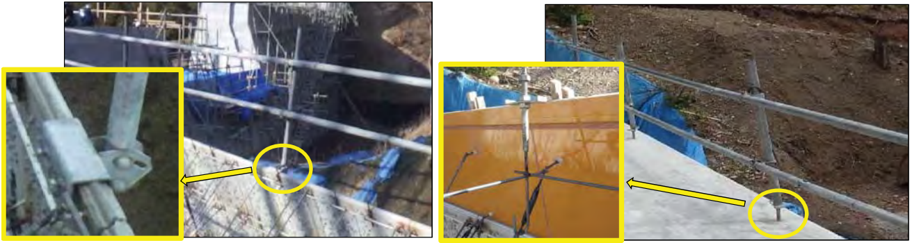
堤体中間地点：専用金具を用いて転落防止施設設対策実施
