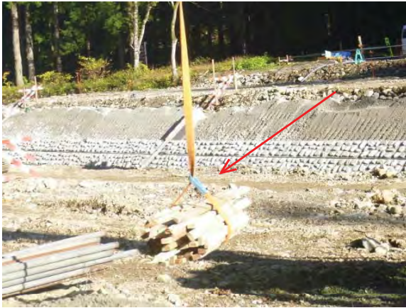
写真7 玉掛けが不安定である
